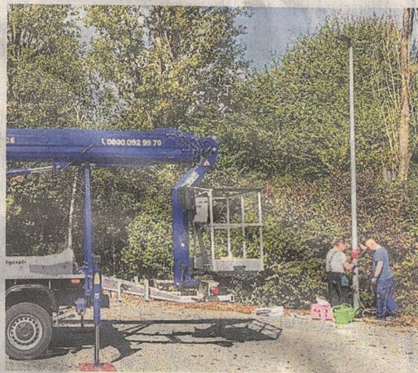
Die Beleuchtung auf dem neuen Schotterparkplatz in Altenhain wurde in diesen Tagen bereits installiert.
